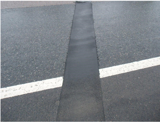
Kuva 19. Bitumiton polymeerimassaliikuntasaumalaite. Kuvassa näkyvät vauriot ja puutteet: massaliikuntasauma on keskeltä notkollaan (vesi saattaa jäädä seisomaan sauman päälle), saumamassan ja asfaltin välinen tartunta on pettänyt (rako massaliikuntasauman ja asfaltin välissä ainakin yläosastaan)
