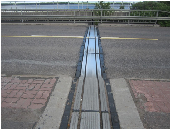
Kuva 22. Mattoliikuntasaumalaite. Kuvassa näkyvät vauriot ja puutteet: kumiprofiili on revennyt kiinnitysten kohdalta, kiinnikkeiden kohdalta puuttuu kumitulppia, kaistojen kohdalta puuttuu tukikaista, kevyen liikenteen väylän kohdalta tukikaistojen vierestä puuttuvat saumabitumit, suojalevyt ovat kuluneet, asfaltissa on purkaumia ja rakoja liikuntasaumalaitteen ja tukikaistojen vieressä, kumiprofiilin urissa on hiekkaa
