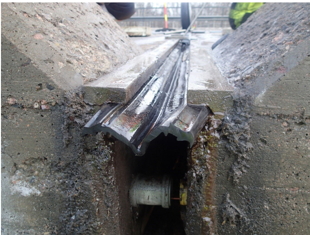
Kuva 8. Yksikuminen liikuntasaumalaite, kuvassa liikuntasaumalaitteen vaurioitunut kumiprofiili on vaihdettu ja teräsprofiilien kumiurasta on puhdistettu ruosteet pois (kuvassa näkyvät vauriot tai puutteet: teräsosia ei ole tuotu reunapalkin ulkopuolelle, kumiprofiilia ei ole asennettu täysin uran pohjaan kiinni)
