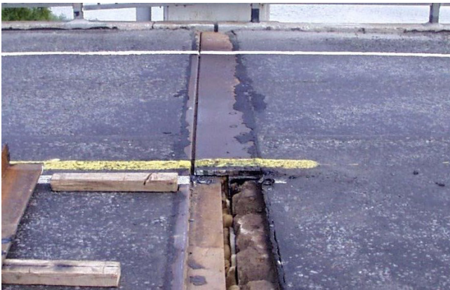
Kuva 2. Avoin turkkilevyliikuntasaumalaite, korjaustyöt käynnissä (kuvassa näkyvät vauriot tai puutteet: liikuntasaumalaitteen tukikaistat puuttuvat, saumabitumi on kulunut pois tai irronnut/irrotettu)
