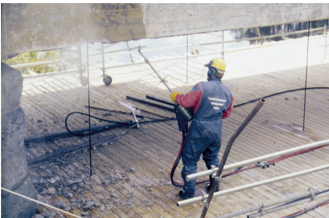
Kuva 27. Työturvallisuus on otettava huomioon telineissä ja kulkuteissä
