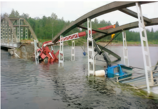
Kuva 11. Henkilövahinkoja aiheuttanut, purkamisvaiheessa sortunut silta
